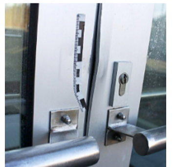
Der Täter hebelte die Tür auf und kam so ins Gebäude. Foto: Paul Frömel
